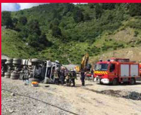
Intervention des pompiers de Courchevel lors d'un accident de camion sur un chantier de terrassement à Méribel
